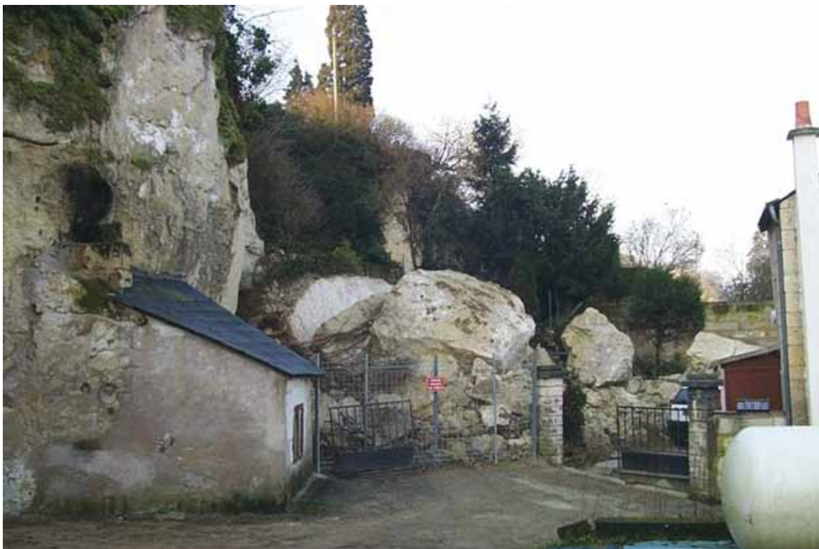
Effondrement à Dampierre sur Loire – descente du coteau Bizeau en janvier 2000. La circulation avait été interdite au public le mois précédent.
